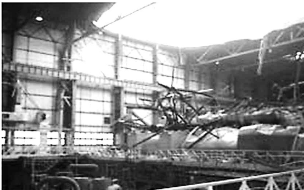
Рис. 1. Последствия пожара масла и водорода с обрушением кровли в машинном зале электростанции
